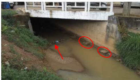
Figura 4-8: OAE na Rua Floriano Berger. Detalhe para as bases de concreto e para o acúmulo de resíduos.
