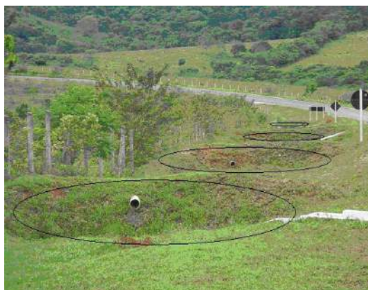
Figura 7-3: Bacias de contenção instaladas às margens de rodovia pavimentada.
