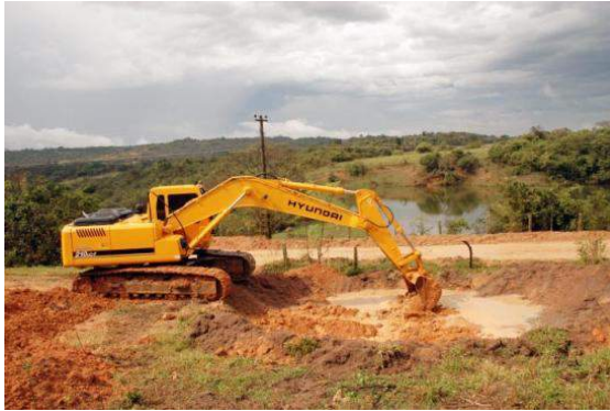
Figura 7-4: Implantação de uma bacia de contenção às margens de uma estrada vicinal
