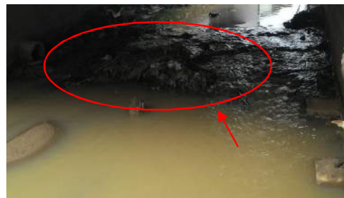
Figura 4-9: OAE na Rua do Imigrante. Detalhe para o acúmulo de resíduos.
